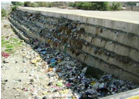
Punto crítico, margen izquierda río Ica, distrito de La Tinguña, Junio - 2012
