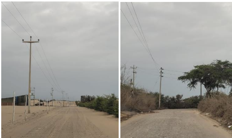
Imagen 27- Redes eléctricas de media tensión en las vías circundantes al predio.
